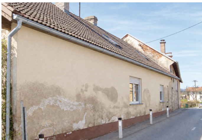
Tipične poškodbe zaradi kapilarne vlage
